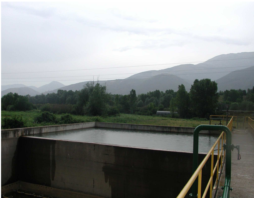
Vasca di denitrificazione – Impianto di depurazione consortile
