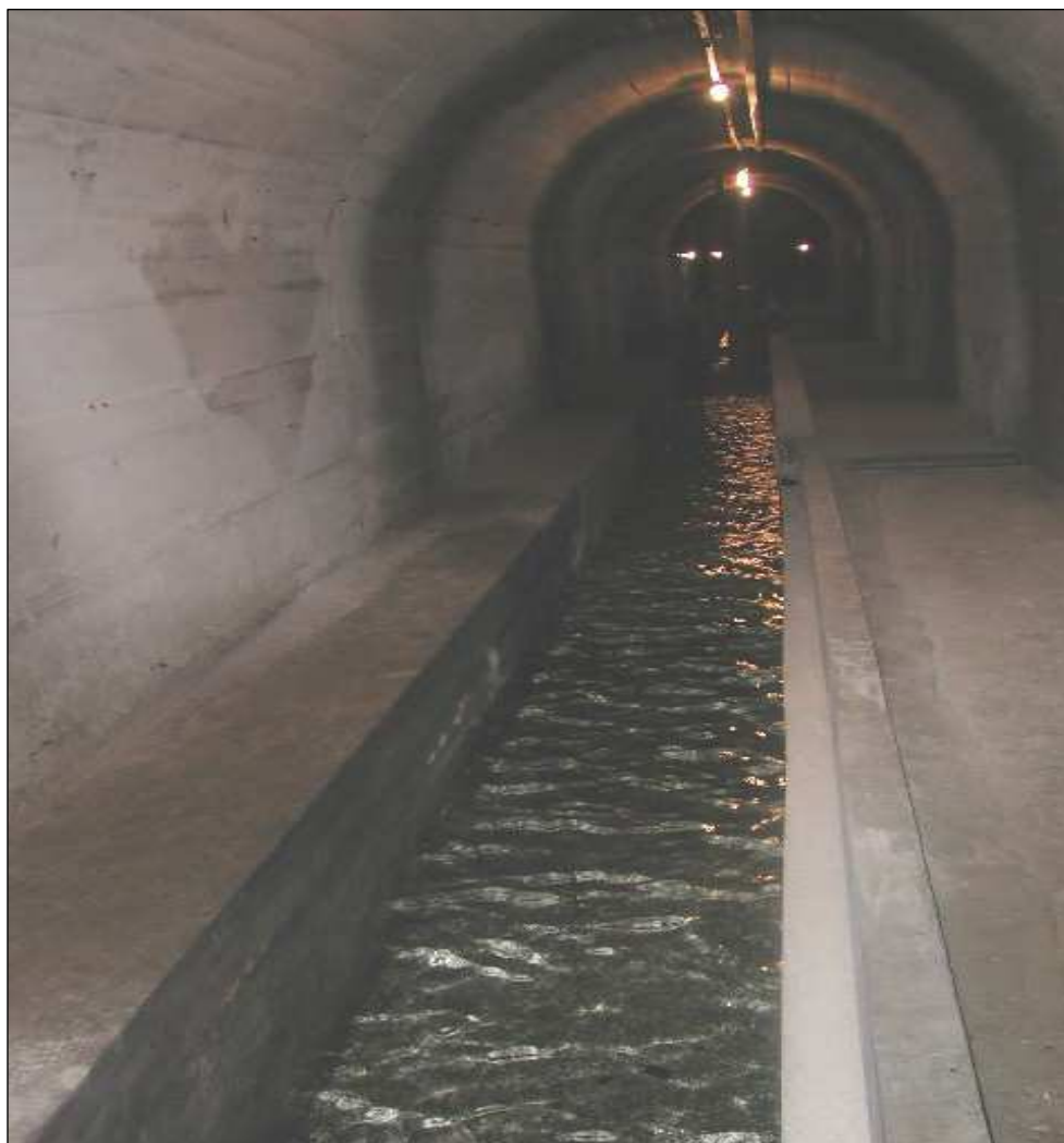
Opera di presa – Acquedotto “Gizio”
