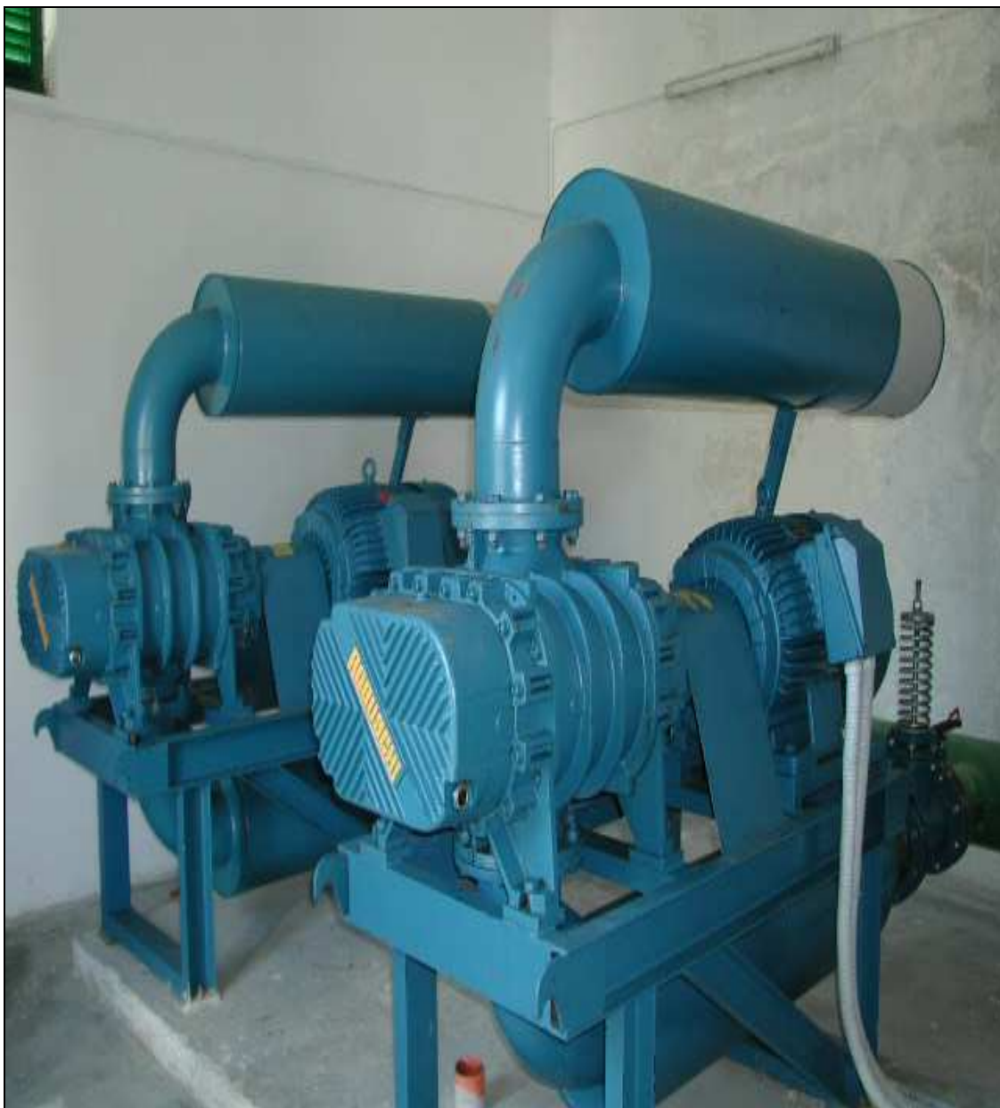
Compressori tipo Robuschi -Impianto di Depurazione Consortile (Corfinio)
