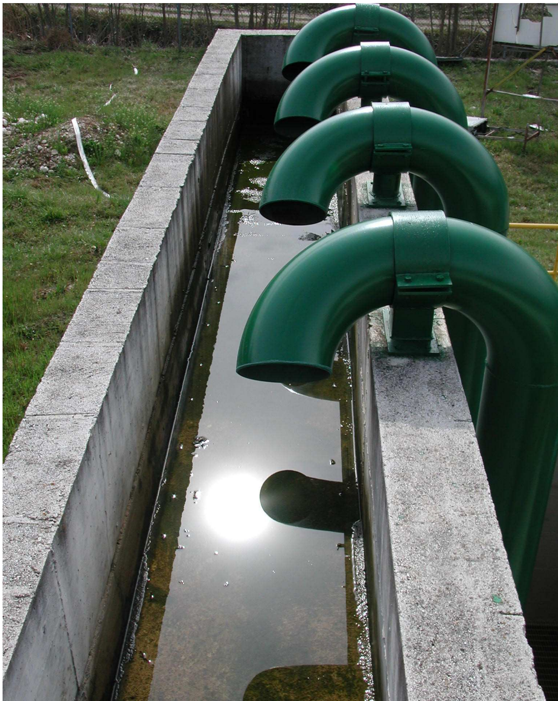
Impianto di depurazione consortile- Sollevamento iniziale
