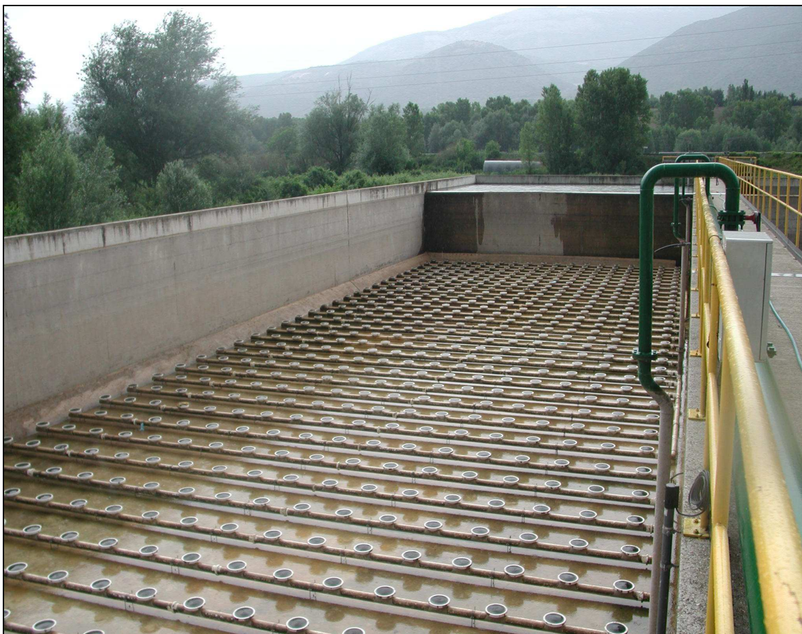
Diffusori vasca di ossidazione -Impianto di Depurazione Consortile (Corfinio)
