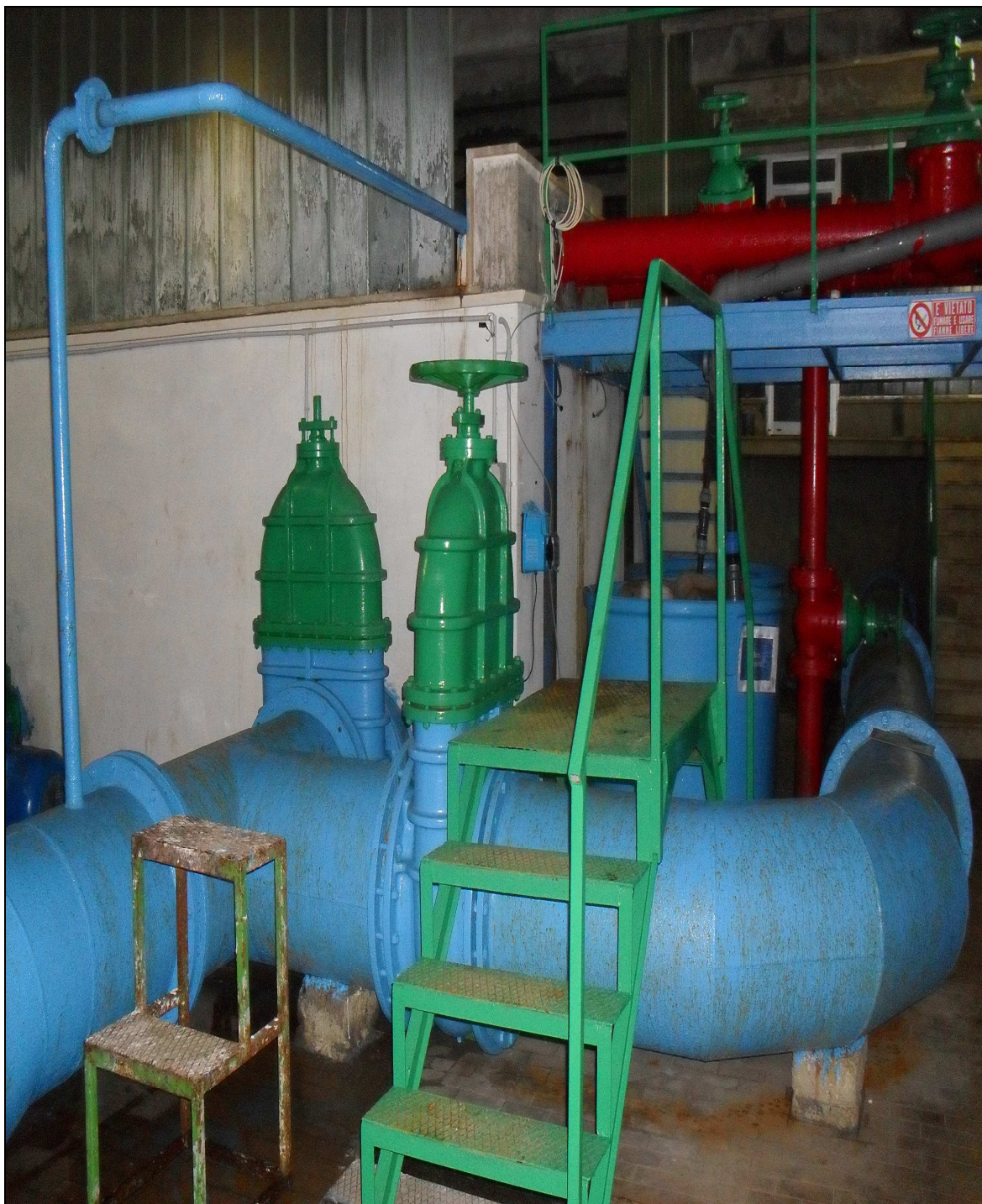
Acquedotto "Gizio" – Vasca di carico e tubazione di partenza
