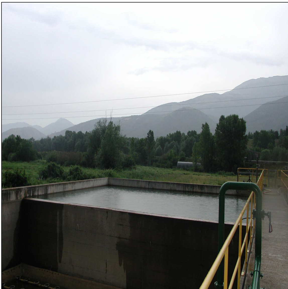
Impianto di Depurazione Consortile (Corfinio)
